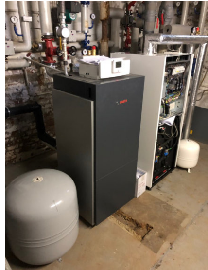
Heizungsanlage kurz nach Einbau und vor Anschluss an die Stromversorgung
